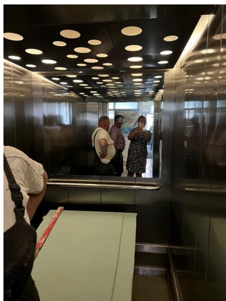
Zdjęcie nr 2: Zbyt niska, ciasna ,ciemna winda z niedostosowanymi przyciskami
