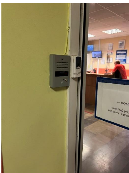
Zdjęcie nr 11: Domofon na nieodpowiedniej wysokości
