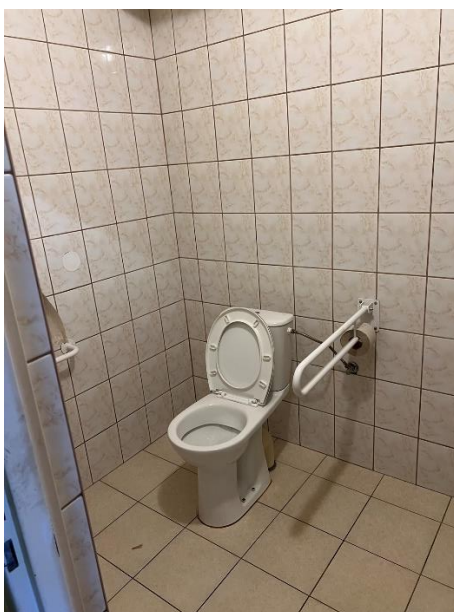
Zdjęcie nr 4: Niewymiarowe toalety
